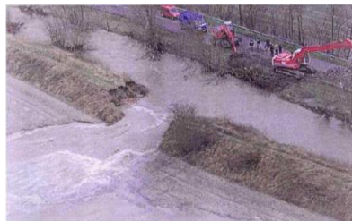
Rupture digue en rive droite de l'Hogneau (2002)
